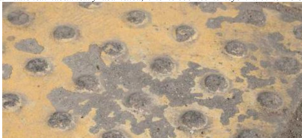
Разрушение тактильных наземных указателей, что не соответствует п. 5.1.3 ГОСТ Р 50597-2017
